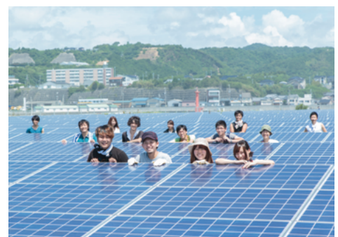
和歌山県印南町に設置した「龍谷ソーラーパーク」
